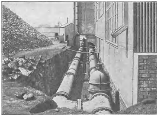
Abb. 149. Nebenwerk Robinson Central. Doppelsammelleitung für die Kompressoren außerhalb des Gebäudes. In der Mitte vorspringend zentralisierte Filteranlage für sämtliche Kompressoren.
