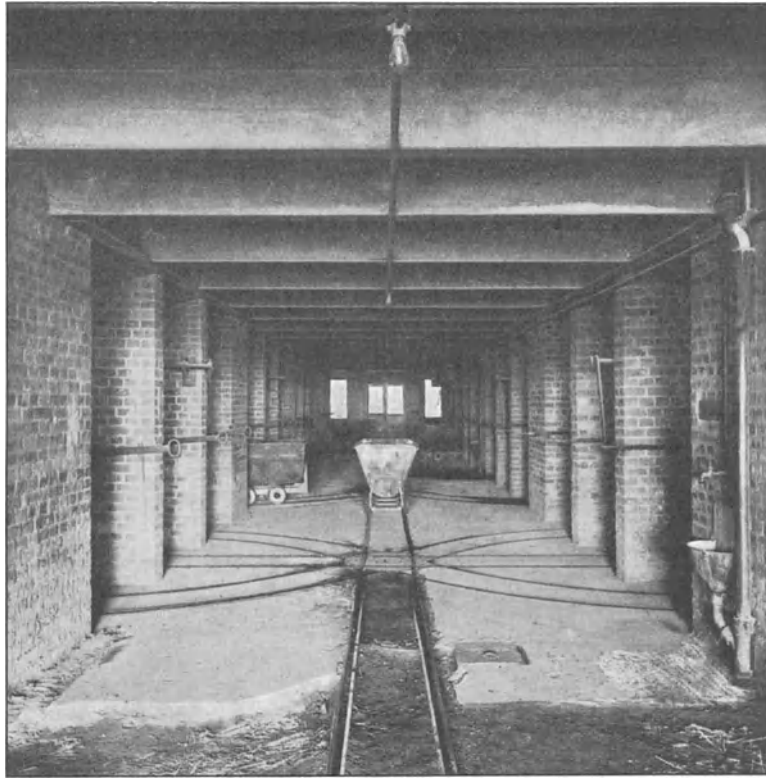
Abb. 21. Einrichtung für den Aschentransport im Keller des E. W. Hirschfelde.
