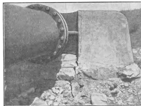
Abb. 157. Druckluftanlage. Verankerung eines 30 zölligen Krümmers über Erde, zeigt Entweichen des Druckpfeilers wegen ungenügender Fundierung.
