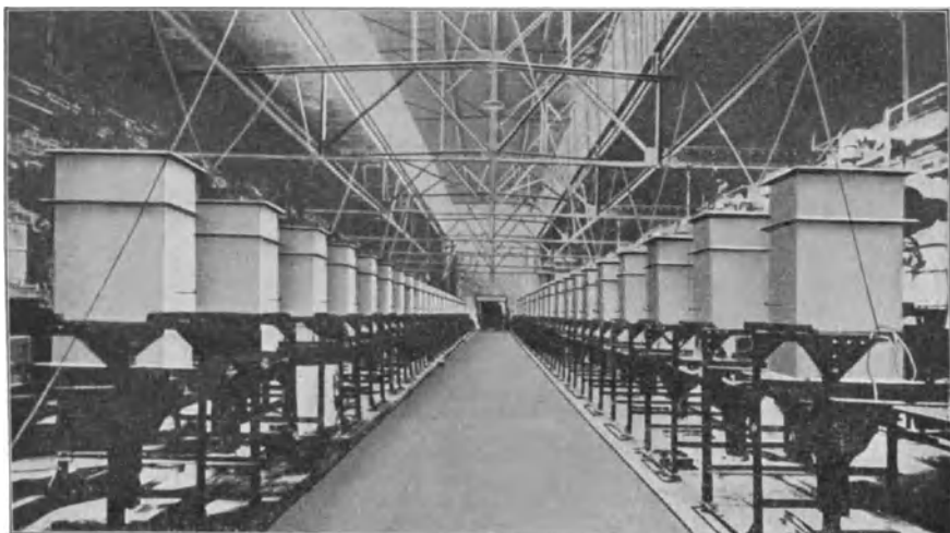
Fig. 20. Innenansicht einer französischen Ammoniakoxydationsanlage.
