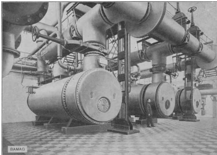
Fig. 8. Abhitzekessel einer Ammoniak-Verbrennungsanlage der Bamag (Tagesleistung etwa 30 t).
