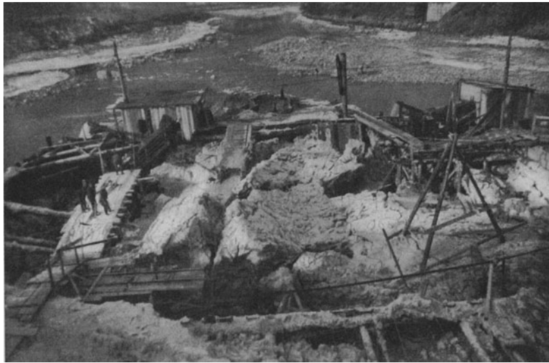
Abb. 295. Reste eines Eisstoßes, der in die Baugrube für ein Wehr in Hallein eingedrungen ist. (H. Rella, Wien.)
