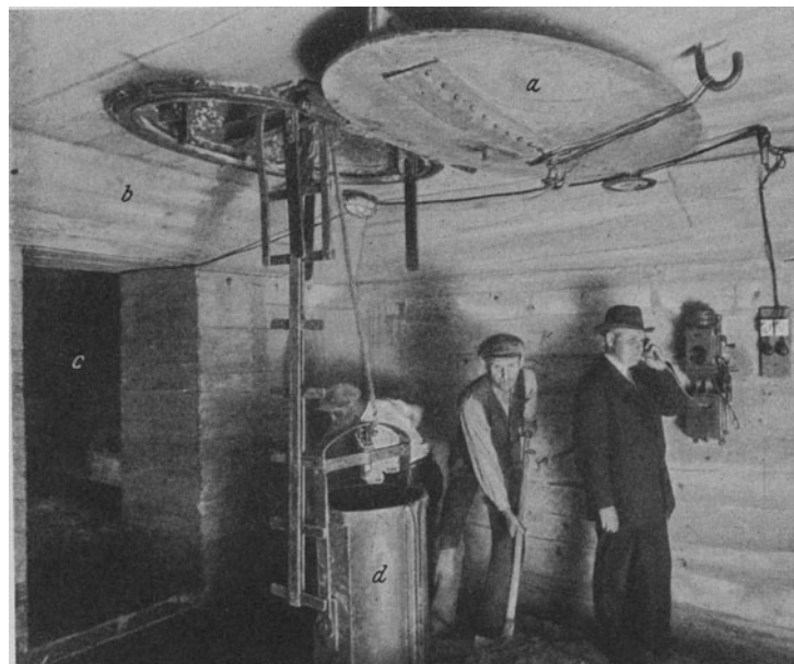
Abb. 641. Innenraum eines Eisenbeton-Druckluftsenkkastens mit Querwänden (b). (Siemens-Bau-Union.) a Verschlussdeckel für das Schachtrohr, c Verbindungstüren in den Querwänden, d Kübel für die Förderung des Aushubes.
