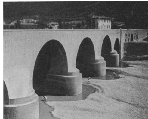
Abb. 113. Kolke an den Köpfen von Brückenpfeilern, aufgenommen nach Ablauf eines Hochwassers.
