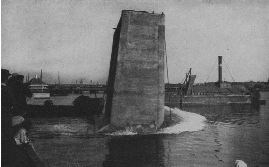
Abb. 429. Ein Eisenbetonschwimmkasten einer Kaimauer in Norresundby (vgl. Abb. 424) beim Ablauf von der Helling. (Christiani & Nielsen m. b. H., Hamburg.)
