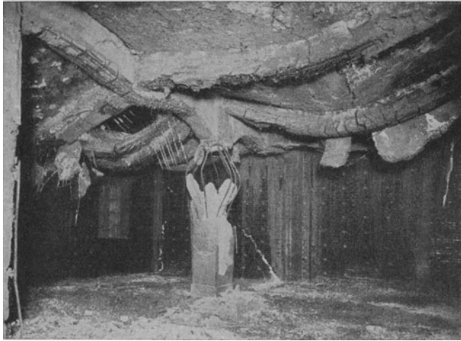
Abb. 712. Erdbebenzerstörungen in einem Seidenhaus (Kempu Soko) in Yokohama. (Nach Briske: Beton u. Eisen 1925.)
