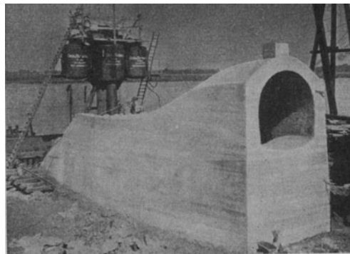
Abb. 678. Der Druckkasten mit dem Mündungsbauwerk eines Regenauslasses in Köln. (Vgl. Abb. 677.) (Grün & Bilfinger.)
