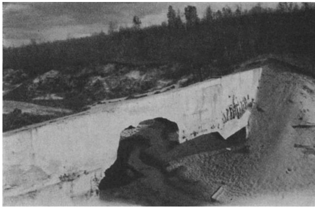
Abb. 94. Grundbruch am Langewaldstaudamm bei Chocopee (Mass.). (Aus Redlich-Terzaghi: Ingenieurgeologie. Berlin: Julius Springer 1920.)
