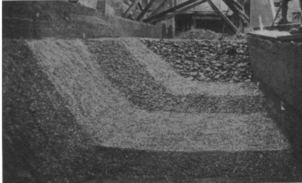
Abb. 100. Dränung der Sohlfläche des Dachwehres in Hallein mittels eines Ambursenfilters (H. Rella, Wien).
