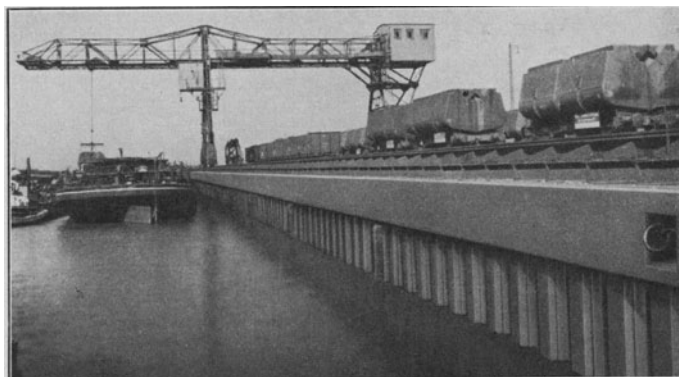
Abb. 192. Uferwand aus Larssen-Eisen mit einem Eisenbetonholm im Hafen der Zeche Fürst Hardenberg. (Vereinigte Stahlwerke A.-G. Dortmunder Union.)
