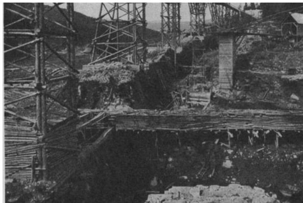
Abb. 292. Überleitung des Packerbaches über die Baugrube der Packerperre in einem Holzgerinne, das durch einen Prügelmantel gegen Beschädigungen beim Sprengen gesichert ist.
