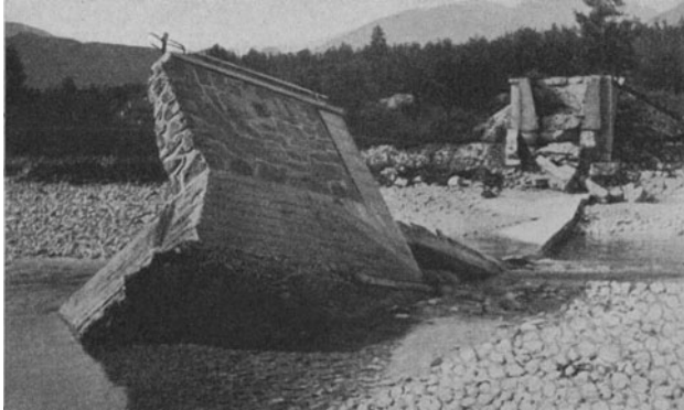
Abb. 115. Einsturz eines ohne Spundwände gegründeten Brückenwiderlagers infolge Unterkolkung gelegentlich eines Hochwassers. (F. Bastl.)
