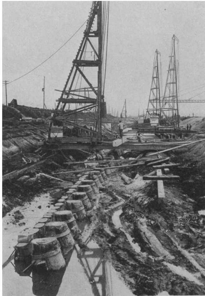
Abb. 534. Pfahlböcke zur Stützung einer Spundwand und zur Aufnahme von Schräglasten. (Ph. Holzmann A.-G., Frankfurt a. M.)
