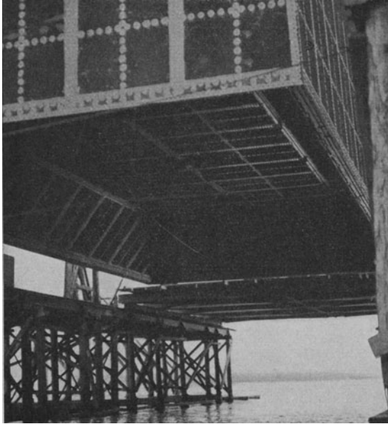
Abb. 626. Ansicht des nach dem Zusammenbau von der Arbeitsbühne angehobenen am Gerüst hängenden Druckkastens für einen Pfeiler der Donaubrücke in Páncsova. (Dyckerhoff & Widmann.)
