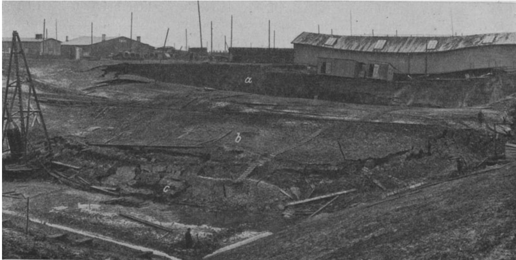
Abb. 216. Böschungsrutschung in einer Baugrube für die Nordschleuse in Bremerhaven infolge Grundbruches. (Vereinigte Stahlwerke A.-G. Dortmunder Union.)
