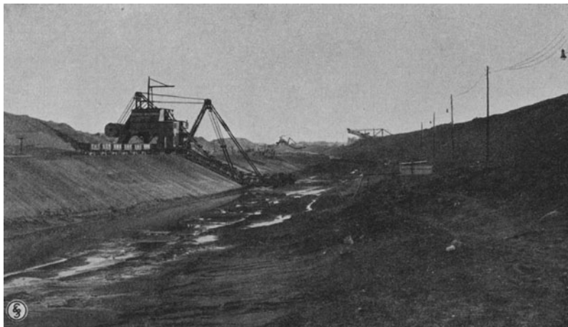
Abb. 232. Eimerkettenbagger mit gebrochener Eimerleiter. (Siemens-Bau-Union.)
