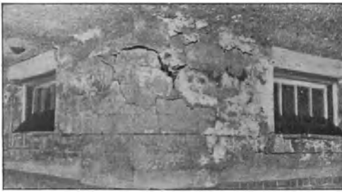
Abb. 8. Zerstörung von Beton infolge schlechter Zuschlagstoffe.
