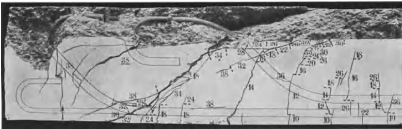
Abb. 138. Erweiterung schiefer Risse an der Stelle fehlender schräger Eisen.
