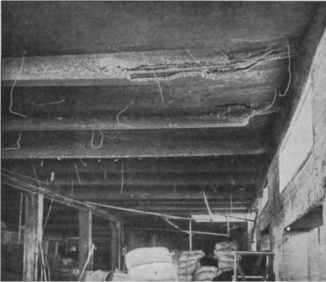
Abb. 78. Das Verhalten von schlecht ausgeführten Eisenbetonunterzügen im Feuer.
