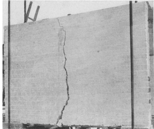
Bild 8. Zementschwemmsteinmauer in Kalkzementmörtel bei zweiseitiger Auflagerung bis zum Bruch belastet
