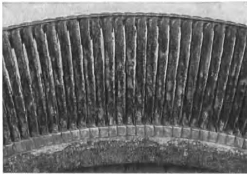
Abb. 128. Starke Korrosion an Stahlschaufeln nach 7 Betriebsjahren.
