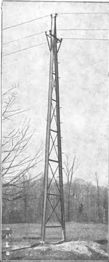
Abb. 72. Beweglicher Zwischenmast mit Stützisolatoren. Rochester and Sodus Bay Power Co.
