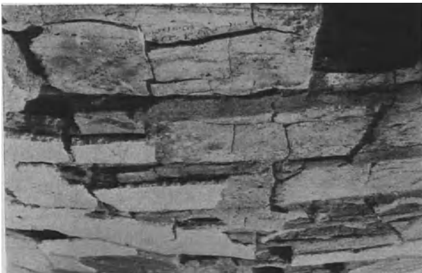
Bild 15. Decke III mit Vorwurf, geputzt mit Kalkmörtel + Gips + Kiesgur; Unterseite nach dem Brand
