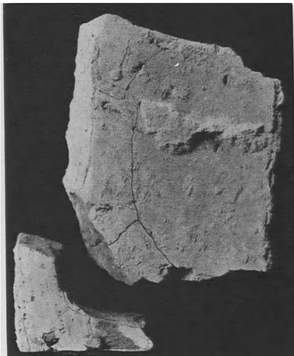
Bild 7. Kantenstück eines Pfeilers aus Mauerziegeln 1. Klasse mit abgelöster Ecke
