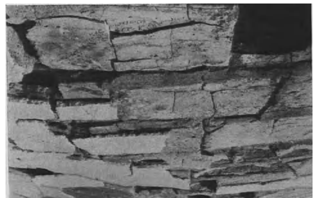
Bild 17. Decke V ohne Vorwurf, geputzt mit Ziegelmehlmörtel; Unterseite nach dem Brand
