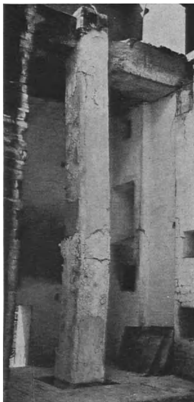
Bild 10. Stütze Ib nach dem Brand
