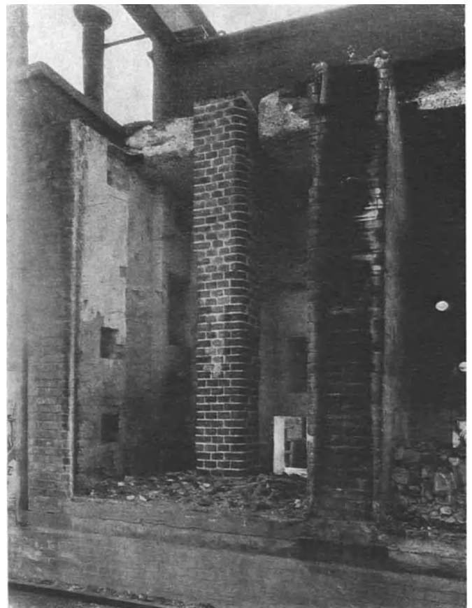
Bild 6. Pfeiler aus Mauerziegeln 1. Klasse in Kalkzementmörtel, ungeputzt, nach dem Brandversuch. Im unteren Teil des Pfeilers sind die lose haftenden Steinschalen und Kanten abgeklöpft
