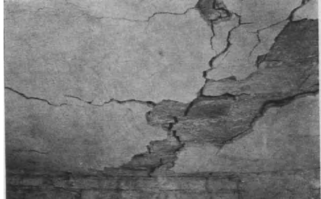
Bild 16. Decke IVa mit Vorwurf, geputzt mit Bimssandmörtel + Zement; Unterseite nach dem Brand.
