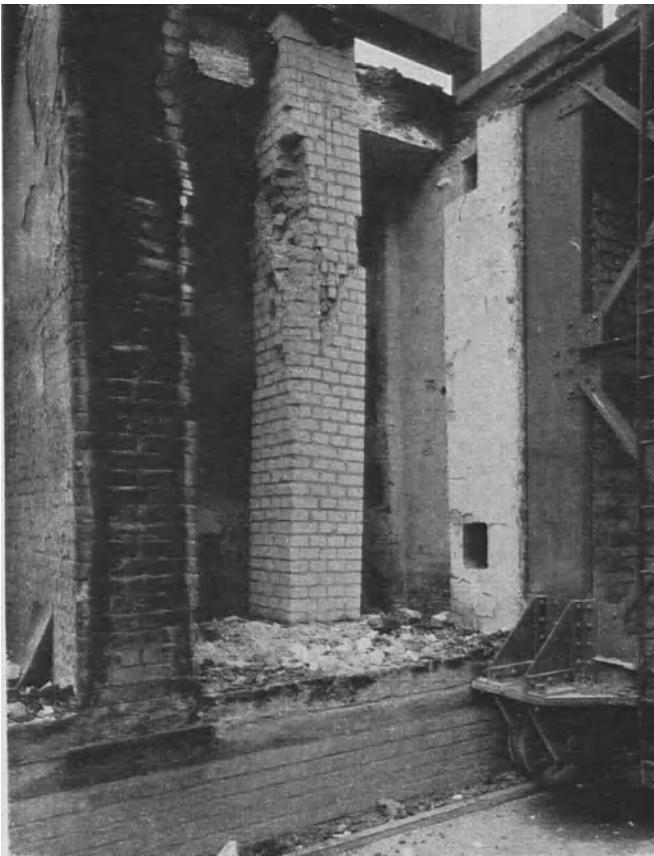
Pfeiler nach der Belastung
