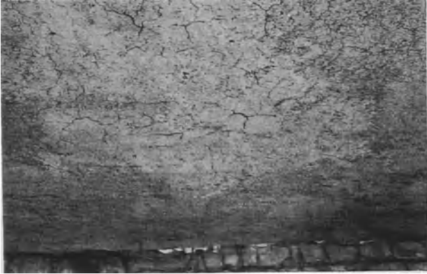
Bild 14. Decke IIb mit Vorwurf, geputzt mit Schamottemörtel + Zement; Unterseite nach dem Brand
