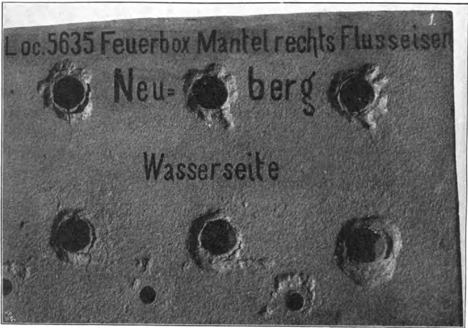
Abb. 62. Wasserseitig korrodierte Seitenwand einer flußeisernen Feuerbüchse.
