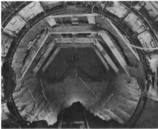
Abb. 272. Stollenvortrieb in plastischem Letten mit unmittelbar nachfolgender Betonierung auf Stahlschalung, d = 3,60 m. (Wasserstollen Detroit 1927, Verw.)
