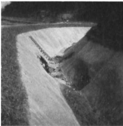
Abb. 220. Sohlen- und Böschungsbruch in einem ausbetonierten Kanal (Ludin).
