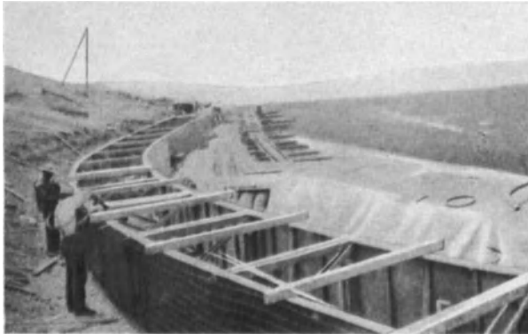
Abb. 246. Eisenbetongerinne fertig zur Torkretierung. (Cement Gun Co., Allentown USA.) Sohlenbreite: 1,75; Tiefe 1,22 m; Wandstärke 5 cm.
