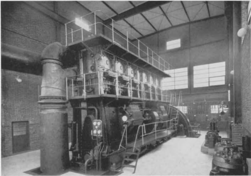
Abb. 15. Umspannwerk Minden der Überlandzentrale Minden-Ravensberg. 1 M.A.N.-Sechszylinder-Spitzdieselmotor von 6900 PS e mit direktgekuppeltem S.S.W.-Drehstromgenerator. Bauart des Dieselmotors: Doppeltwirkender Zweitakt mit Umkehrschlitzspülung und luftloser Brennstoffeinspritzung. Drehzahl 215 in der Minute.
