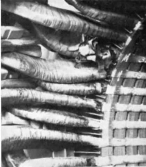
Abb. 24. Elektrodynamische Wirkungen von Kurzschlüssen auf die Ständerspulenköpfe eines 12000-kVA-Turbogenerators 3000 U/min alter Bauart.
