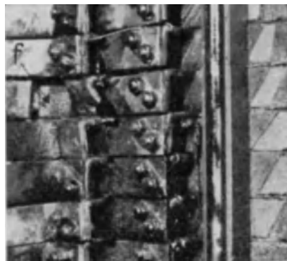
Abb. 121. Zerstörungen an den Kupferleitern unter dem „Nest“.
