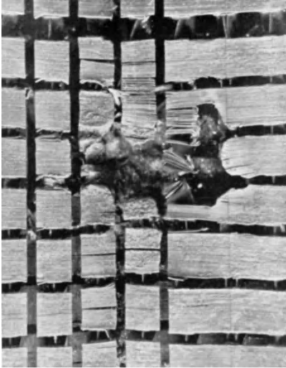
Abb. 11. Eisenschluß infolge loser Blechung im Ständer eines 4-poligen Einphasen-Turbogenerators aus dem Jahre 1912.
