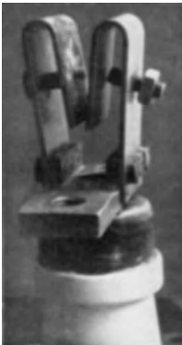
Abb. 139. Trennschalter mit seitlicher Kontaktabhebung. Das Schaltmesser war durch den Bolzen gegen Auswerfen verriegelt.
