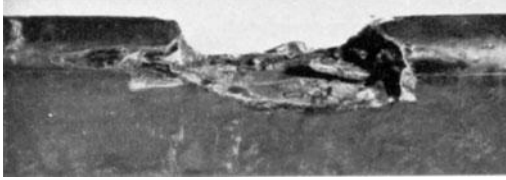
Abb. 15. Durch Blitzschlag im Netz beschädigte Spule eines Drehstromgenerators 750 kVA, 10000 V.
