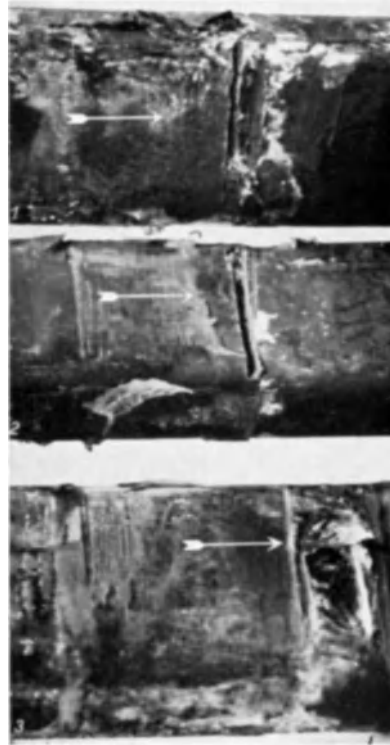
Abb. 10. Beschädigungen der Spulenisolation eines 3500-kVA-Einphasengenerators durch lose Endbleche und lose Preßfinger.
