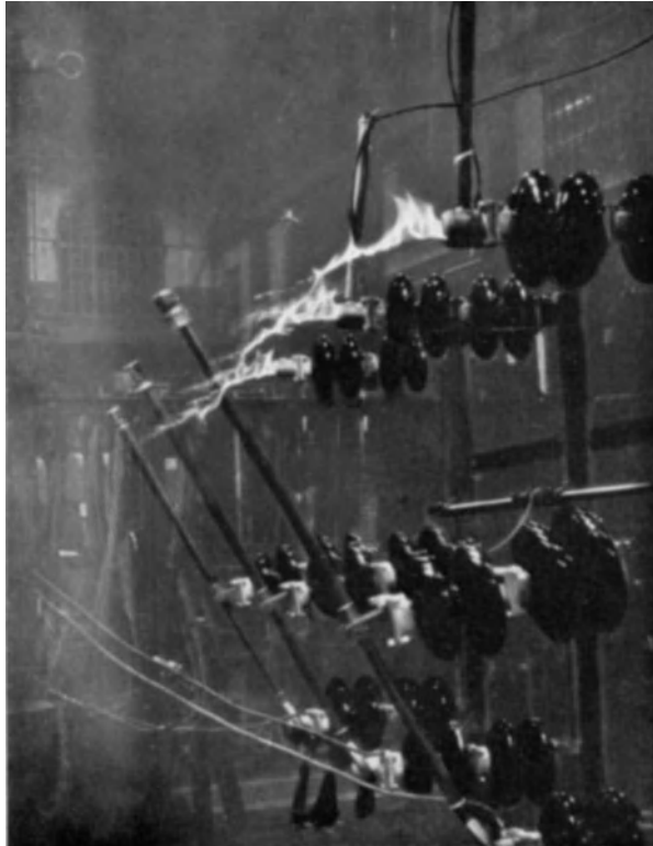
Abb. 141a. Lichtbogen beim Abtrennen eines leerlaufenden Transformators von 1500 kVA, 50 kV.
