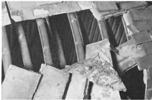
Abb. 244. Durch Staubverpuffung zerstörte Abdeckung einer Brennkammer.
