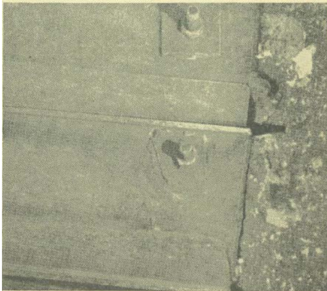
Рис. 59. На снимке, полученном с помощью воздушной пирамиды в очень мутной воде р. Нарвы, видны детали железобетонных конструкций и раковины в бетоне (белые точки).
