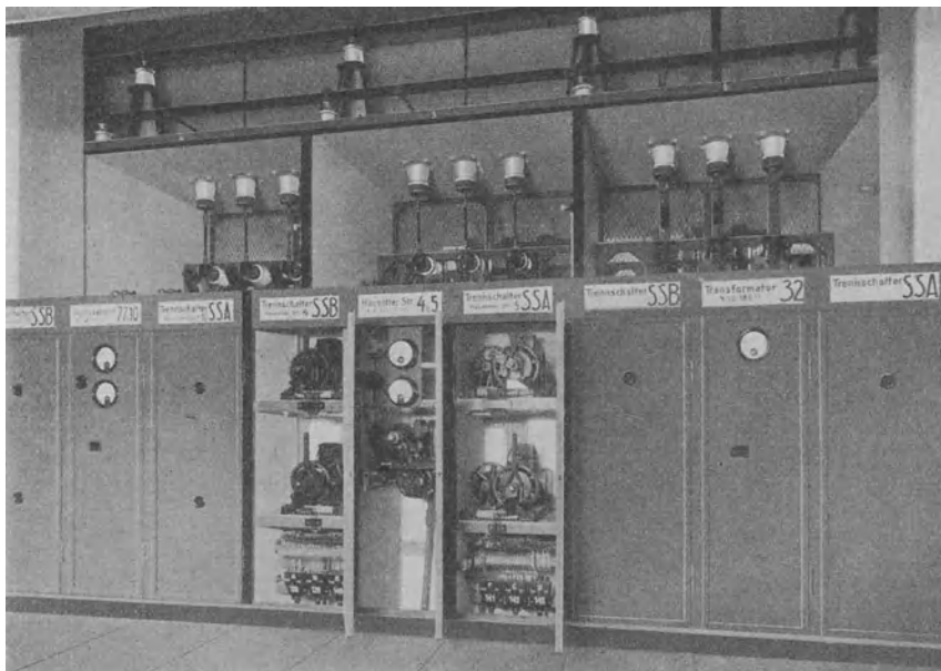
Abb. 265. In Wandschränke eingebaute Antriebsmotoren für Öl- und Trennschalter. B.
