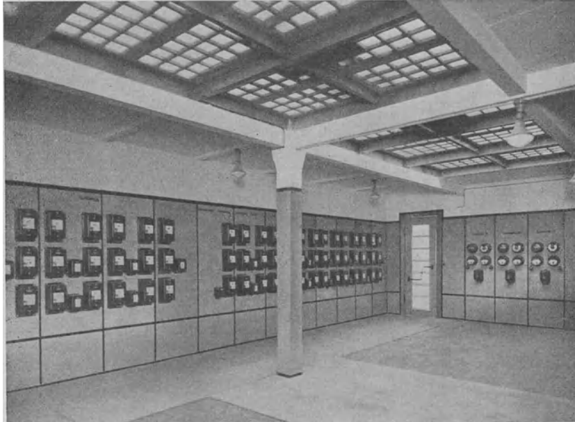
Abb. 369. Relaisraum im Kraftwerk Moabit der Bewag, AEG.
