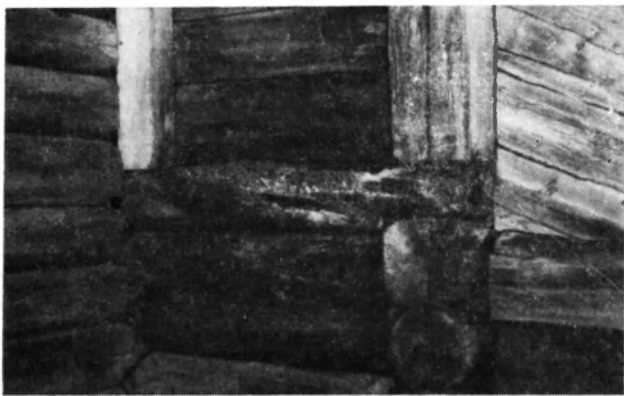
91. Кижы. Музей-заповедник. Гниль в зоне примыкания стен, возникшая в результате попадания воды с крыши
