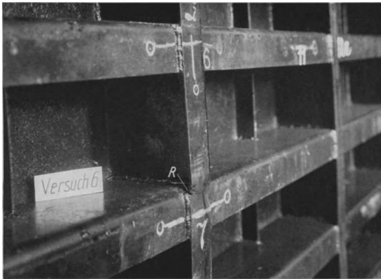
Abb. 11. Träger, Querkzugbänder, Stege und Hilfsstege der Stahlzellendecke 6. Querkzugband bei R gerissen.
