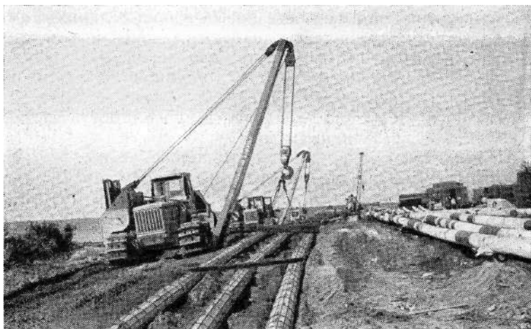
Подготовка труб к прокладке уникальной кабельной линии через Неву на острове Белый.
