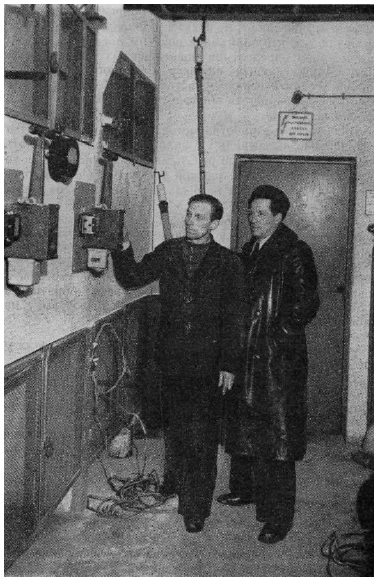
А. Г. Григоренко и В. Д. Еремеев у смонтированного ими устройства автоматического включения резерва.
