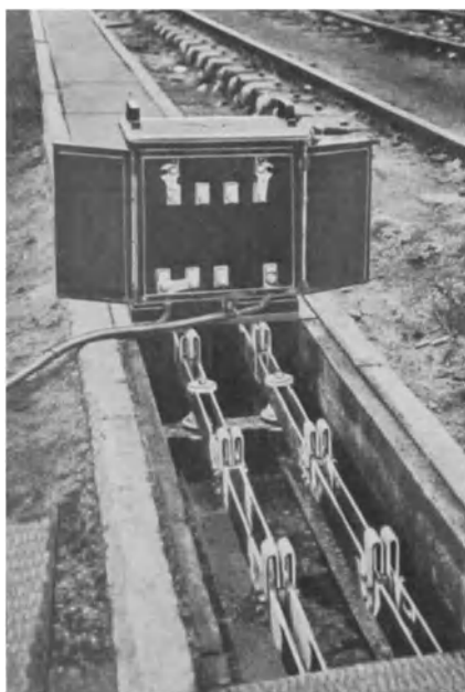
Abb. 63. Sammelschiene für mehrere Schweißstellen, mit aufgesetztem Regelwiderstand.
