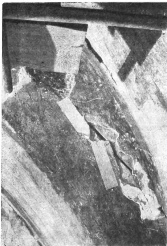
Рис. 1. Троицкий собор. Трещина на западной стороне южной подпружной арки
