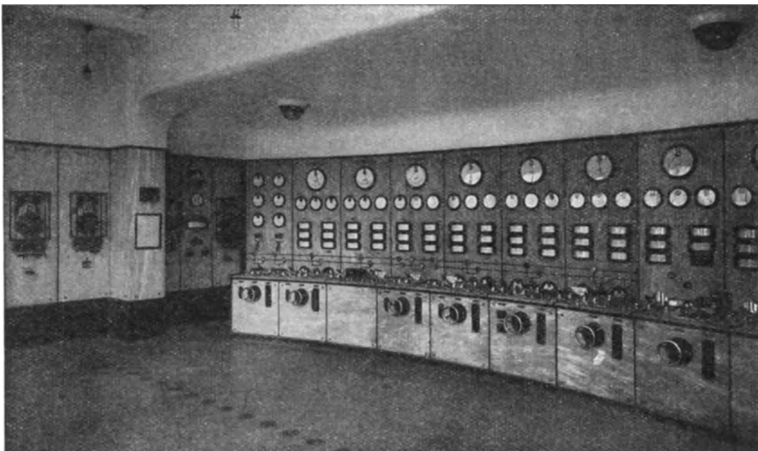
Abb. 737. Bedienungs- und Meßinstrumente im Maschinenraum.
