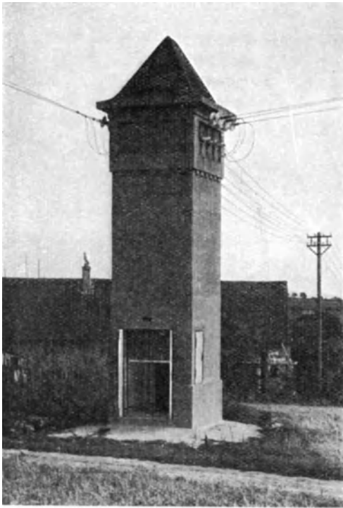
bb. 366. Umspannstation für 20 000 V in Göllheim. SSW.
