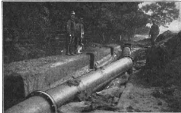
Abb. 623. Druckluftanlage. 22 zöll. Rohrleitg., die infolge starken Regens unterwaschen und aus dem Graben gehoben wurde.
