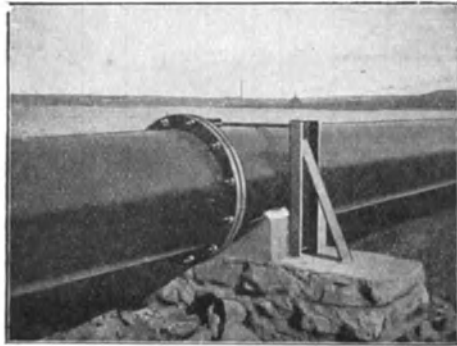
Abb. 620. Druckluftanlage. 24zölliges Rohr; Rohrbefestigung über Erdboden auf gerader Strecke.
