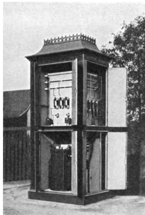
Abb. 362. Transformatorsäule mit 50 kVA Transformator 6500/200—115 V, 1 Ölschalter, Trennschalter, je 2 ankommende und abgehende Hochspannungskabel, eine Niederspannungsschalttafel für 6 Verteilungskabel. Morsell bei Antwerpen. Soc. d'El. de l'Ercaut. SSW.
