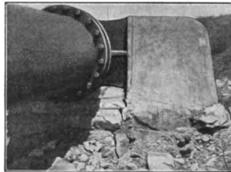
Abb. 622. Druckluftanlage. Verankerung eines 30zölligen Krümmers über Erde, zeigt Entweichen des Druckpfeilers wegen ungenügender Fundierung.
