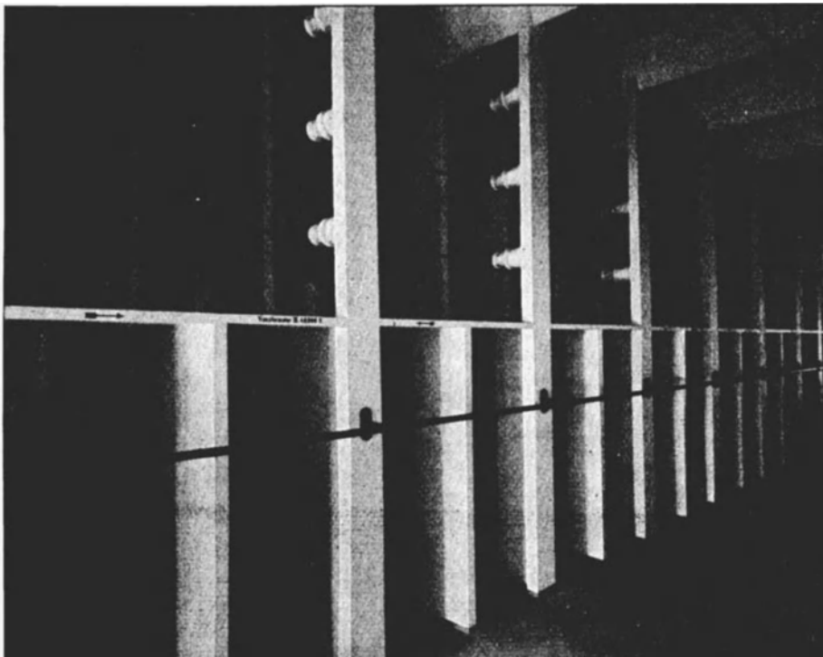
Abb. 508. Sammelschienen im E. W. Hirschfelde 40000 V. Trennwände in Duroplatten; zwischen den Sammelschienen keine Trennwände.
