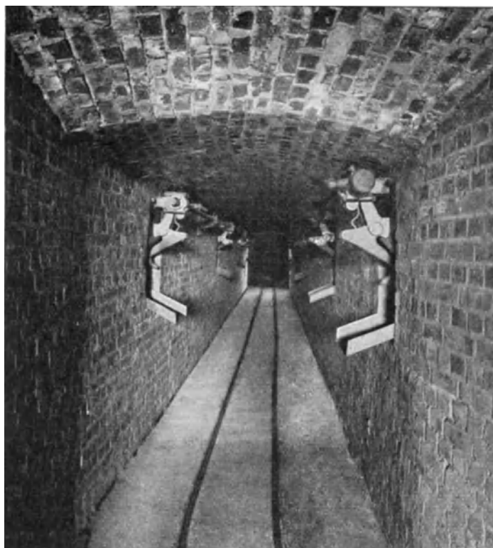
Abb. 414. Aschentunnel unter den Kesseln im E.W. Hirschfelde.
