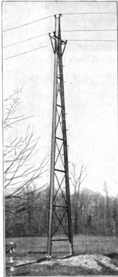
Abb. 102. Beweglicher Zwischenmast mit Stützisolatoren. Rochester & Sodus Bay Power Co.
