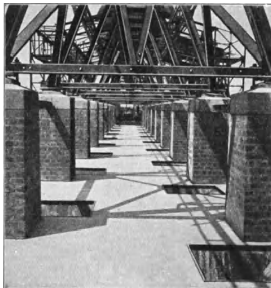
Abb. 632. Kraftwerk Vereeniging. Kohlenlager unterhalb der Kohlenbahn, auf dem Boden Einfalltrichter für die Becherkette.
