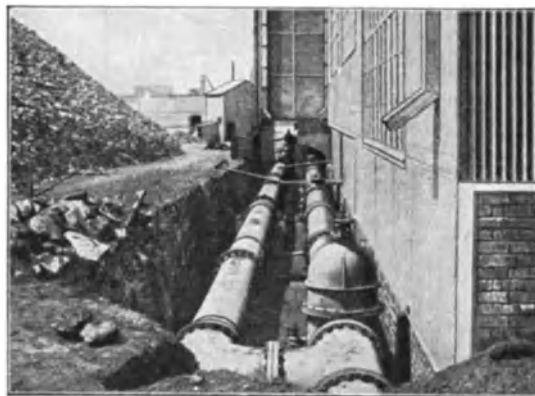
Abb. 611. Nebenwerk Robinson Central. Doppelsammelleitung für die Kompressoren außerhalb des Gebäudes. In der Mitte vorspringend zentralisierte Filteranlage für sämtliche Kompressoren.
