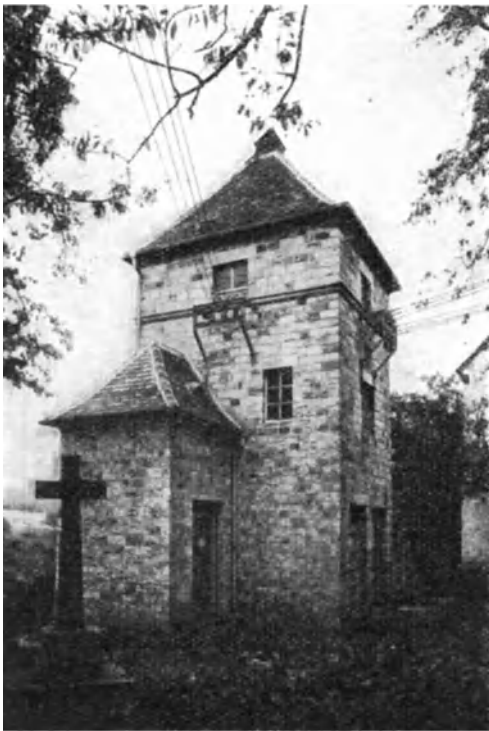
ob. 368. Umspannstation für 20 000 V in Leimen. SSW.
